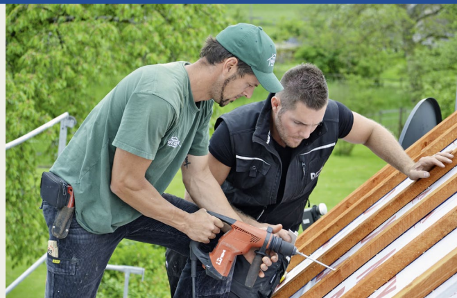
Nach den Vorgaben eines objektspezifisch erstellten Verschraubungsplans wurde die Konterlattung durch die Dämmelemente hindurch mit den darunter liegenden Sparren verschraubt.
