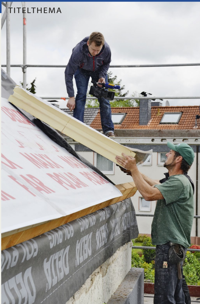
Die erste Reihe der Dämmelemente verlegten die Dachdecker entlang des zur Lagesicherung dienenden Schubholzes. Die nach unten hin überstehenden Federn der Elemente waren zuvor sauber abgeschnitten worden.
